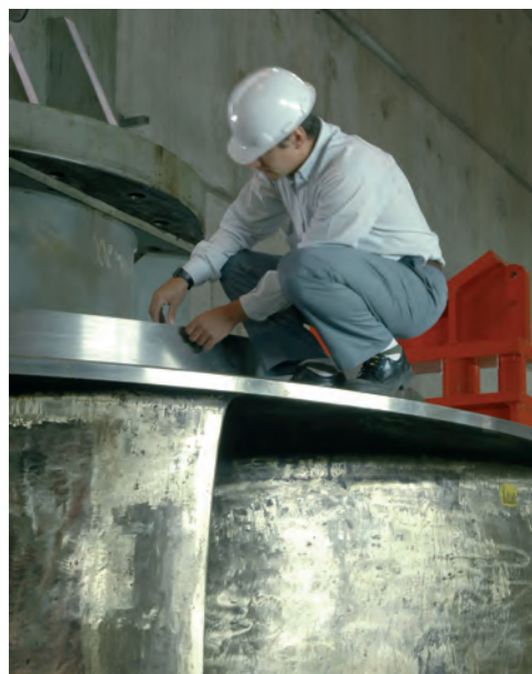
Detalle de una de las turbinas Francis instaladas en el complejo
