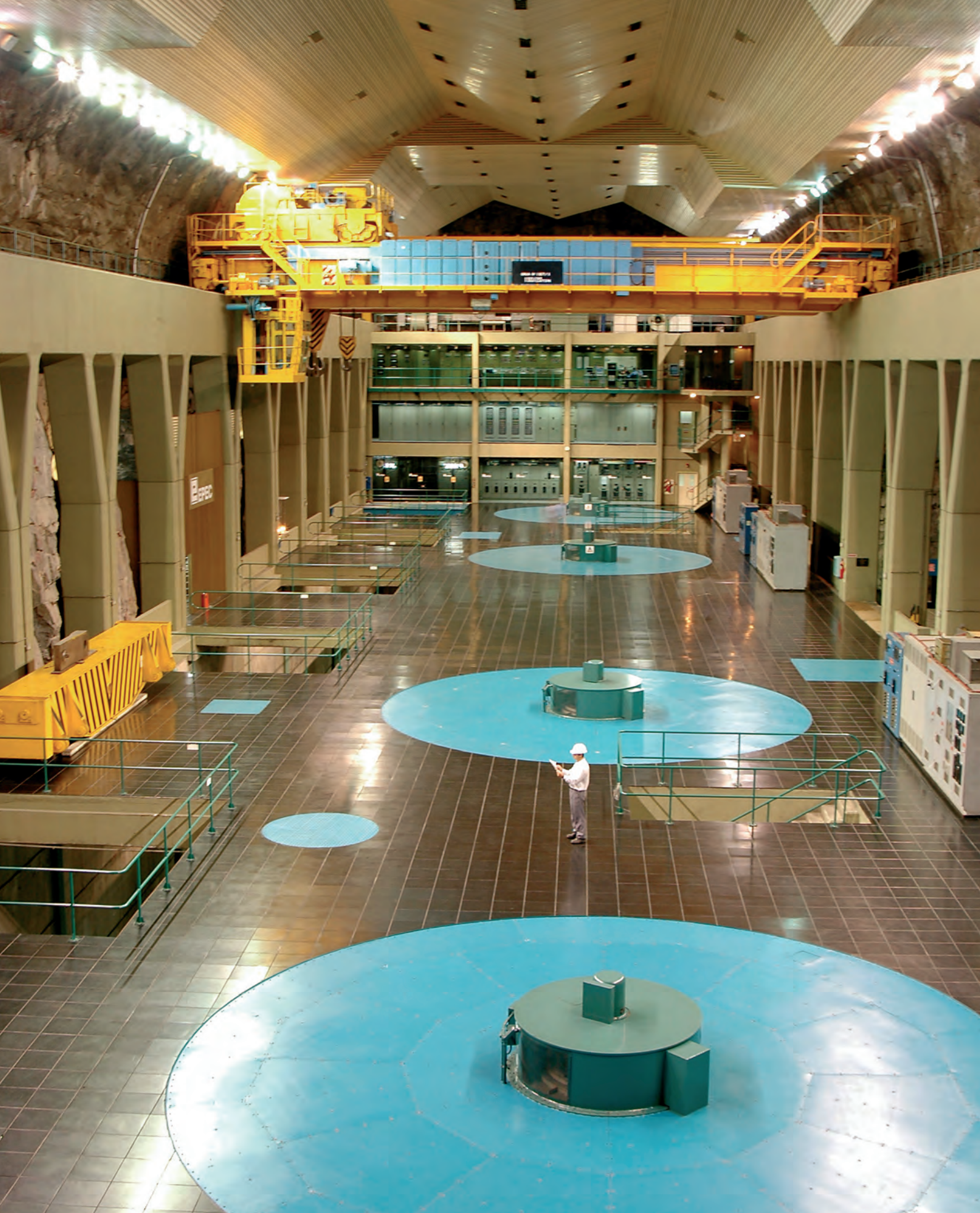
La central en caverna con sus 4 generadores de eje vertical y los tableros eléctricos que alimentan los distintos servicios auxiliares. Al fondo se observa la sala de mando, desde la cual se comandan las unidades.
